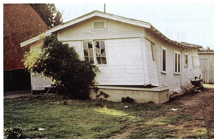
Abb. 1: Gebäude der Holztafelbauart nach einem Erdbeben. Trotz starker Verformungen ist die Standsicherheit noch gegeben.
